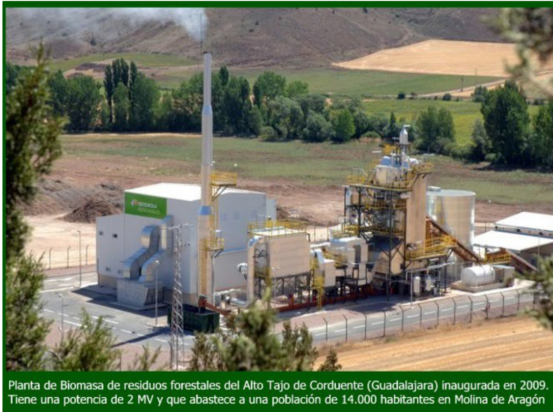
Figura 2. Planta de biomasa de IBERDROLA con producción eléctrica a partir de residuos forestales.
