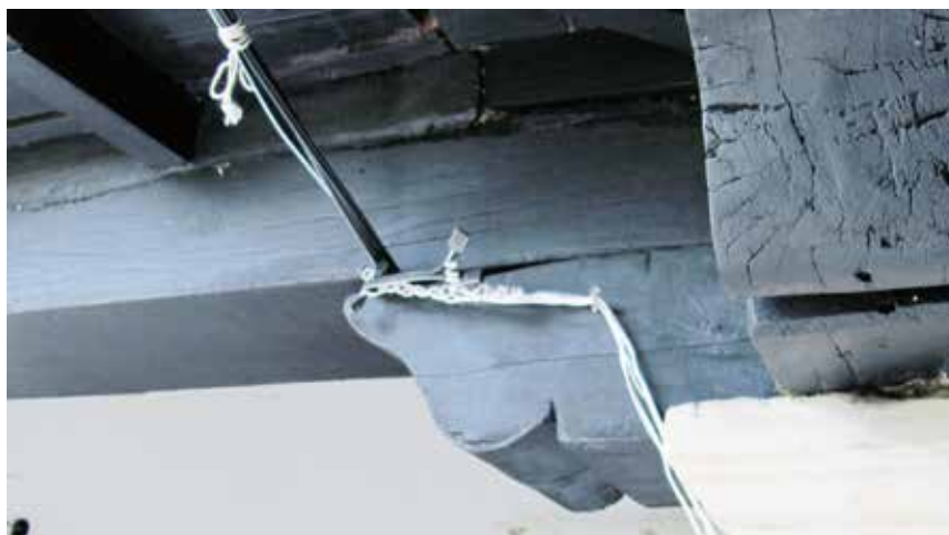
Figura 9. Instalación eléctrica inadecuada- Casa Museo del Fundador. Fuente: autor
